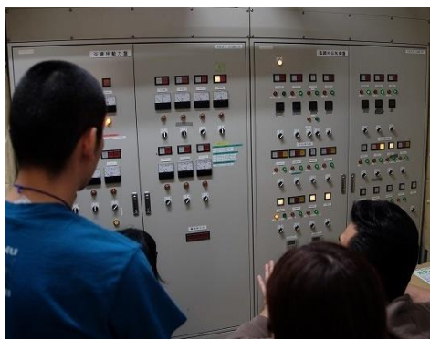
バックヤード見学
