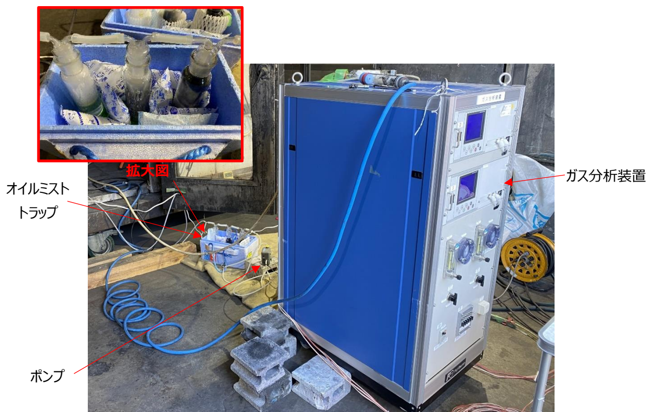
図 36 ガス分析装置及びポンプ等の設置状況
