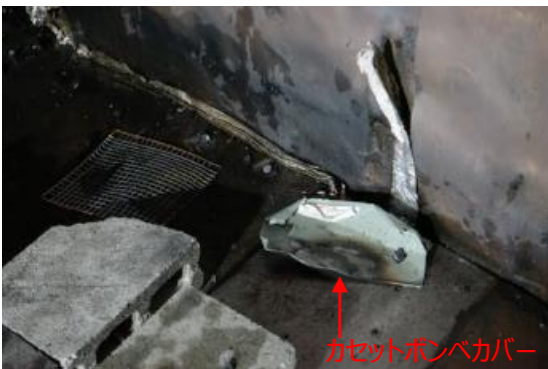
飛散物の状況
